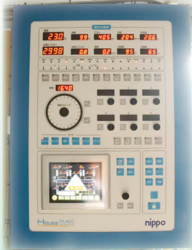
▲環境制御システム
